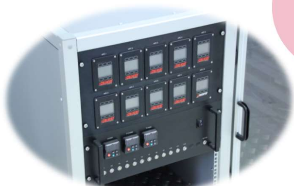
Contrôle d'un banc de dilution
